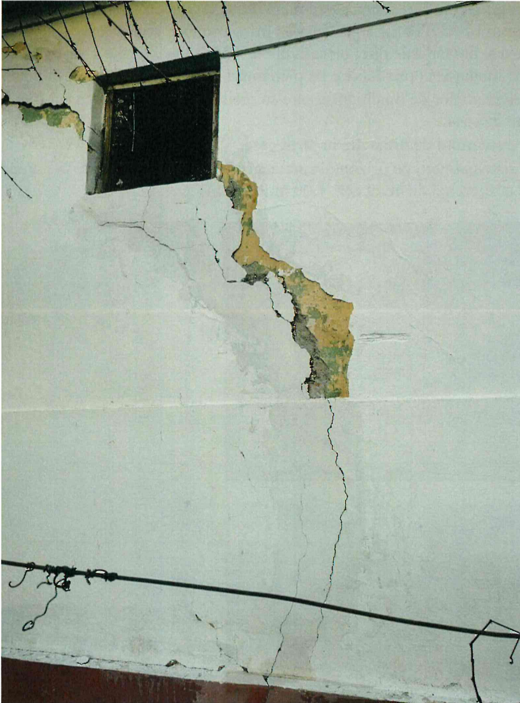
Ruperea peretelui prin tasarea fundatiilor
