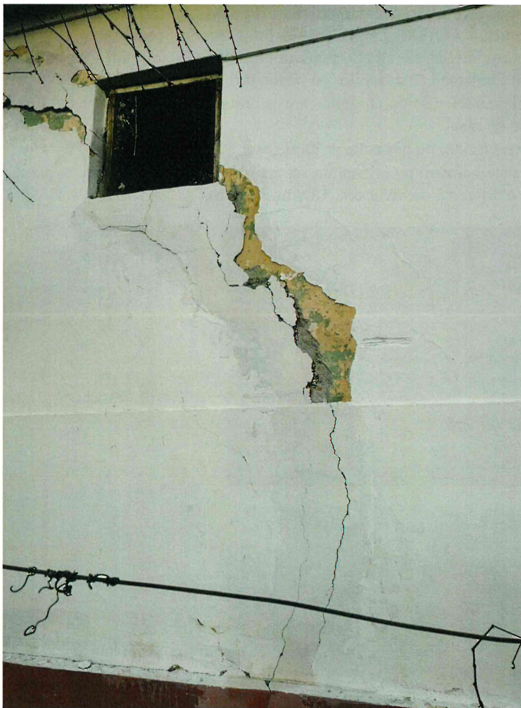
Ruperea peretelui prin tasarea fundatiilor
