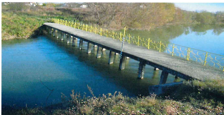
Mira hidrometrica montata pe pasarela pietonala
